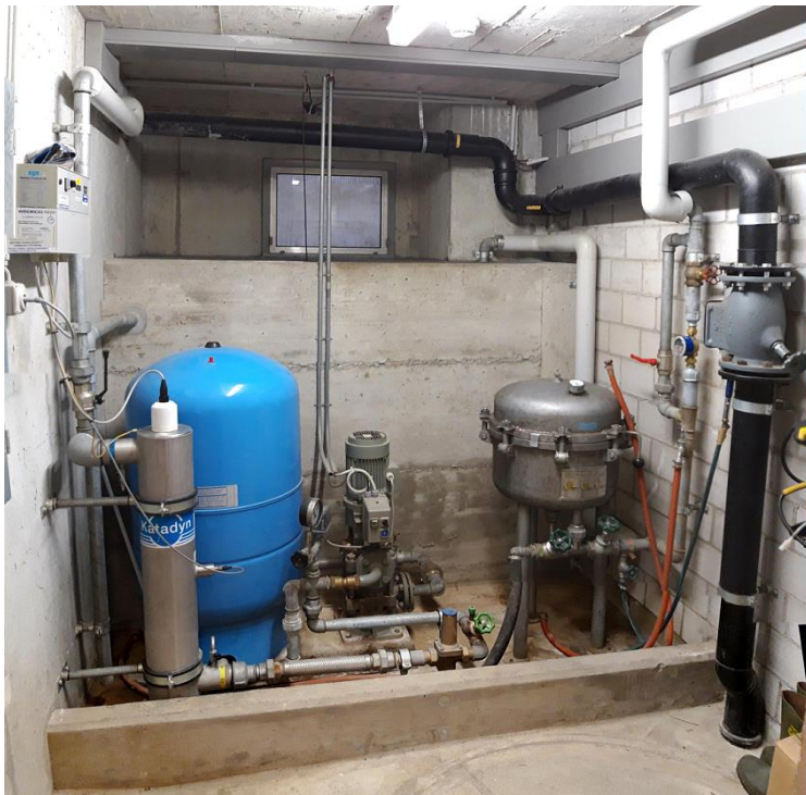
Trinkwasser-Aufbereitungsanlage im Lagerhaus. Mit dem Anschluss an die Wasserversorgung Hemberg werden Keramik-Filter (rechts) und UV Bestrahlung (links) nicht mehr notwendig sei. (Foto U.Herzog, 2019)
