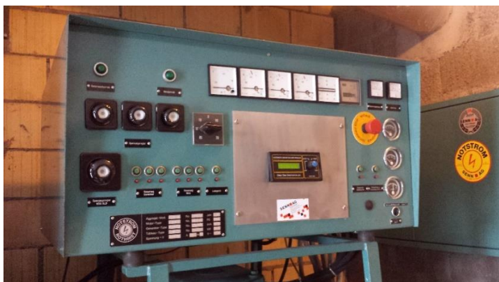
Steuerschrank des Notstrom-Dieselmotors im angebauten Schopf (Haus Nordost Seite)
